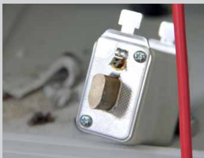
Rys. 9 Uszkodzenia zabezpieczeń nadmiarowo-prądowych spowodowane eksplozją ogranicznika.
